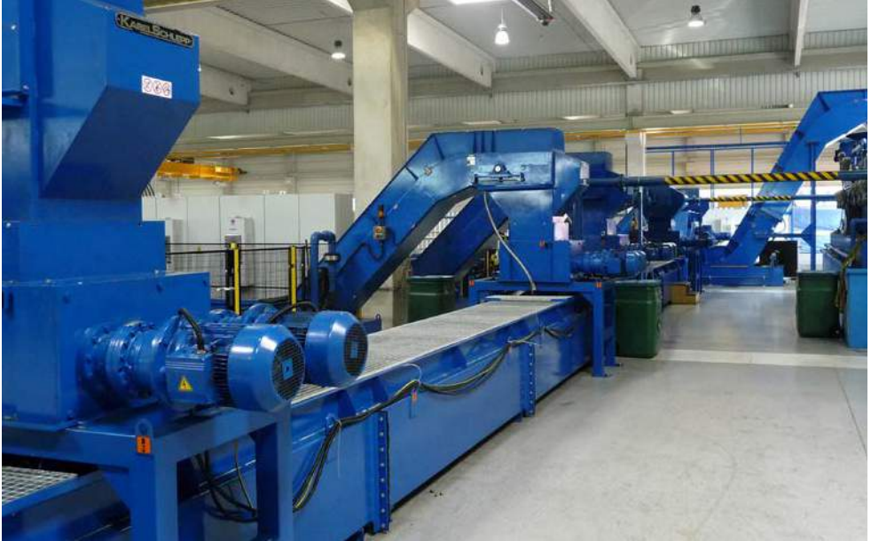
Zentrale Späneentsorgung und Aufbereitung. Central chip disposal and processing.
