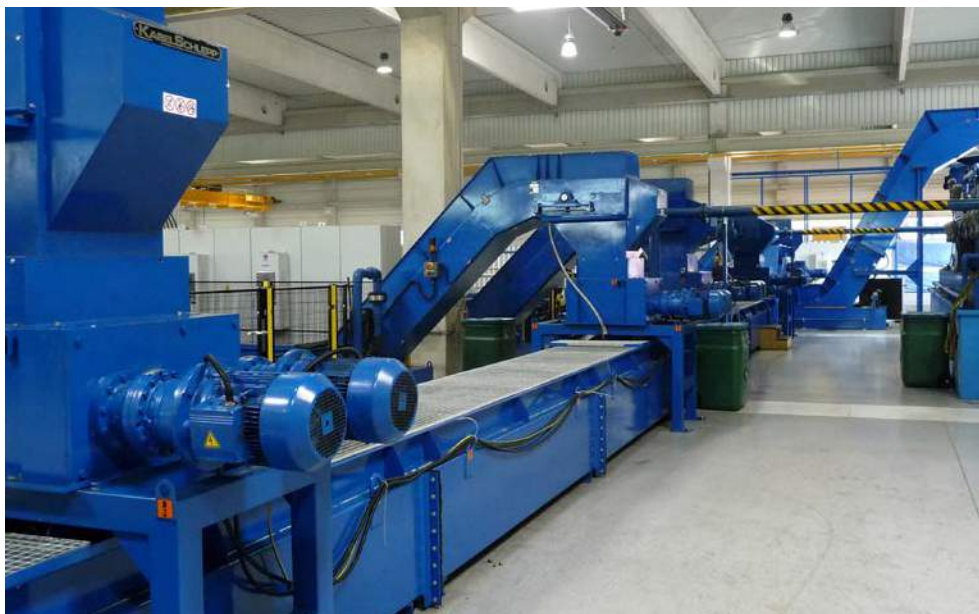
Impianto centralizzato per trasporto e frantumazione truciolo speciale. Central chip disposal and processing.
