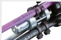
Zugentlastung zur sicheren Fixierung der Leitungen
