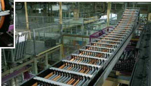
Catene portacavi serie M su magazzino automatico. (Foto: BMW AG)
